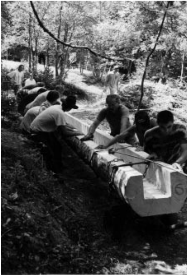
Chantier de rénovation de la scierie hydraulique avec l'association des Amis du patrimoine de Bellecombe : installation du bief.
